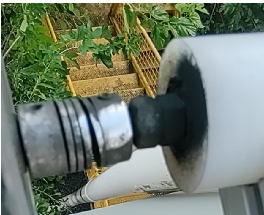
figura 7. Acoplamento flexível desgastado.
